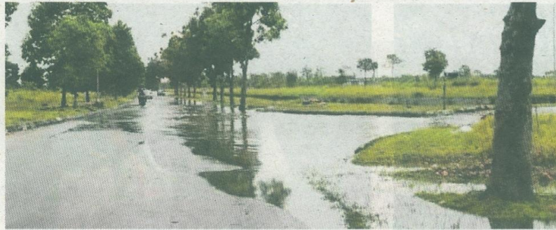
Keadaan air yang melimpah di laluan jalan utama Bandar Mahkota.
